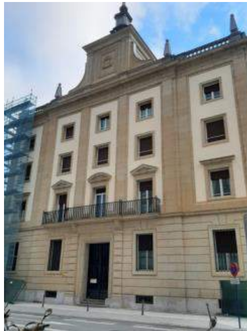
Obras de restauración de fachadas de la Subdelegación del Gobierno en Álava
